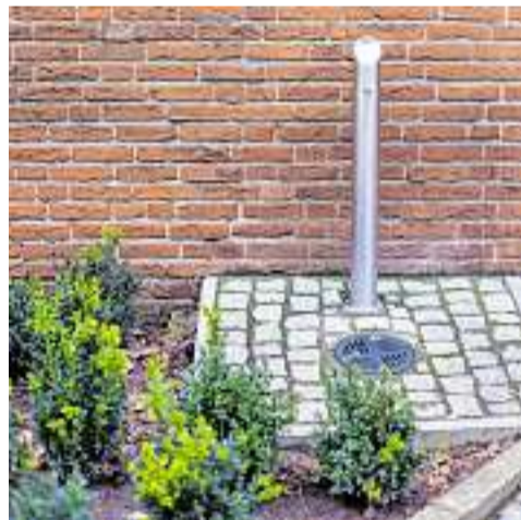
Die Propsteigemeinde St. Johann hat eine Trinkwasserstelle installiert. FOTOS: MICHAEL GALIAN
