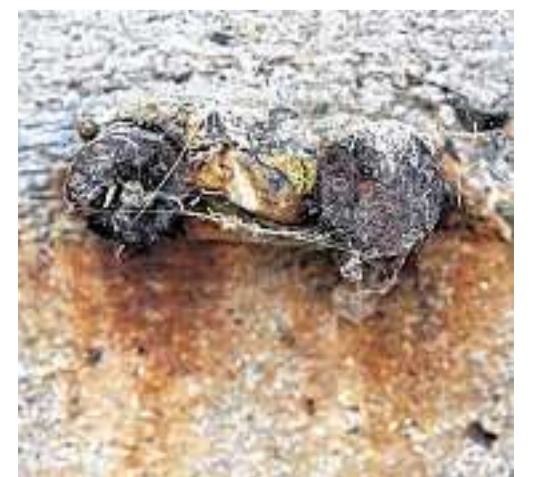
Aus dem Mauerwerk ragen Stahlenden.
